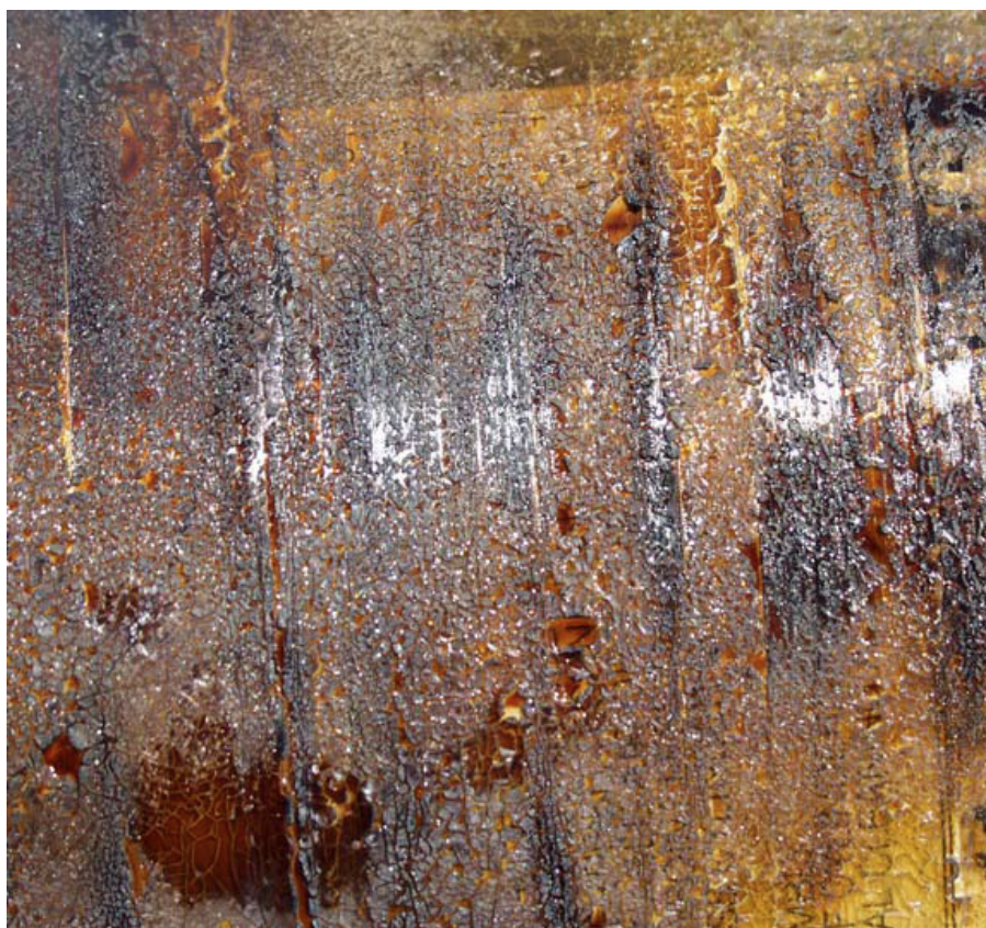
^ Daños causados por el fuego
